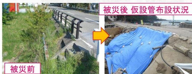
図12. 大船渡市の水道管の被害状況
