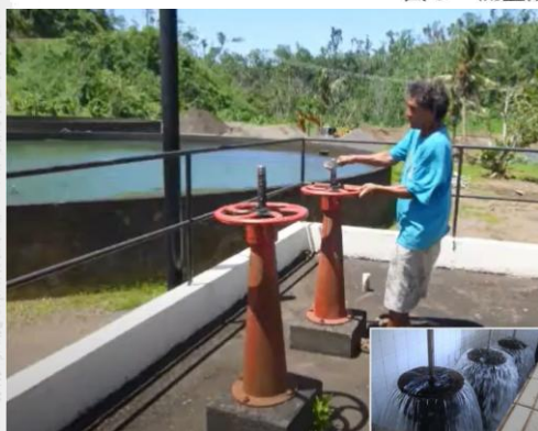
図9 ろ過池を見ながら操作
