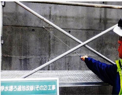
図9 ろ過池壁の亀裂は無かった
