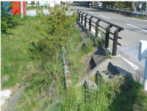
図11 震災前、橋部分は配管は向き出し
